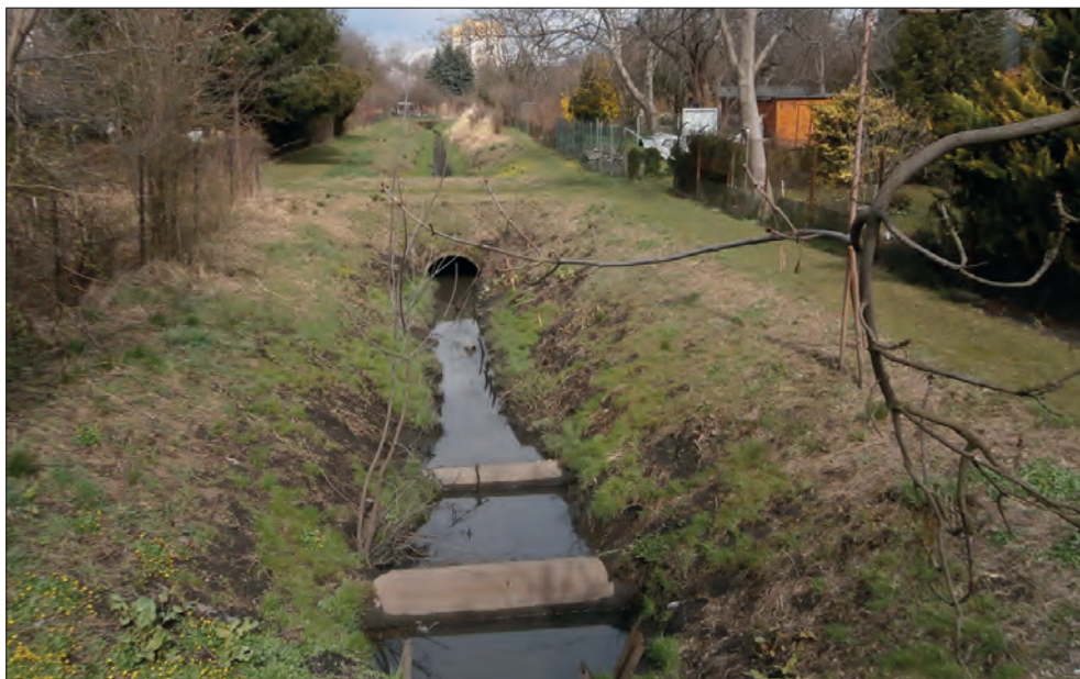
Sadurka na poziomie ulicy Drygały (na styku Okęcia i Rakowca), 13 kwietnia 2022, fot. B. Wierzbicka
