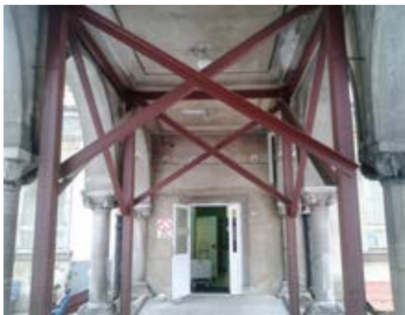
Arkady łącznika między gmachem głównym a budynkiem administracyjnym (podparte ze względu na zły stan techniczny), 2015, fot. E. Popławska-Bukała
