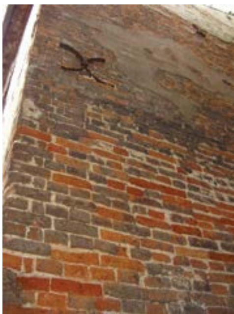
Fragment południowej ślepej ściany szczytowej oficyny Wejchenbergów, widoczne zakończenia kotew, luty 2016, fot. J. Sujecki
